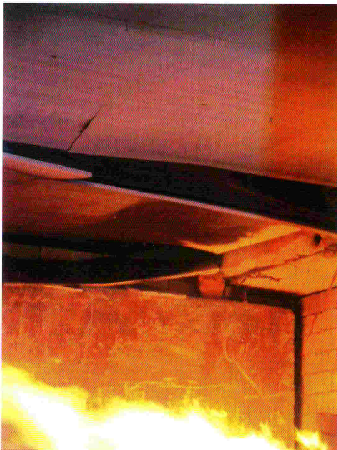
Рис. 6. Частичное обрушение 2-го (внутреннего) слоя листов ГВЛ (образец № 2, вид в смотровое окно).
